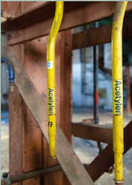
Hier strömt kein Schweißgas mehr aus.
