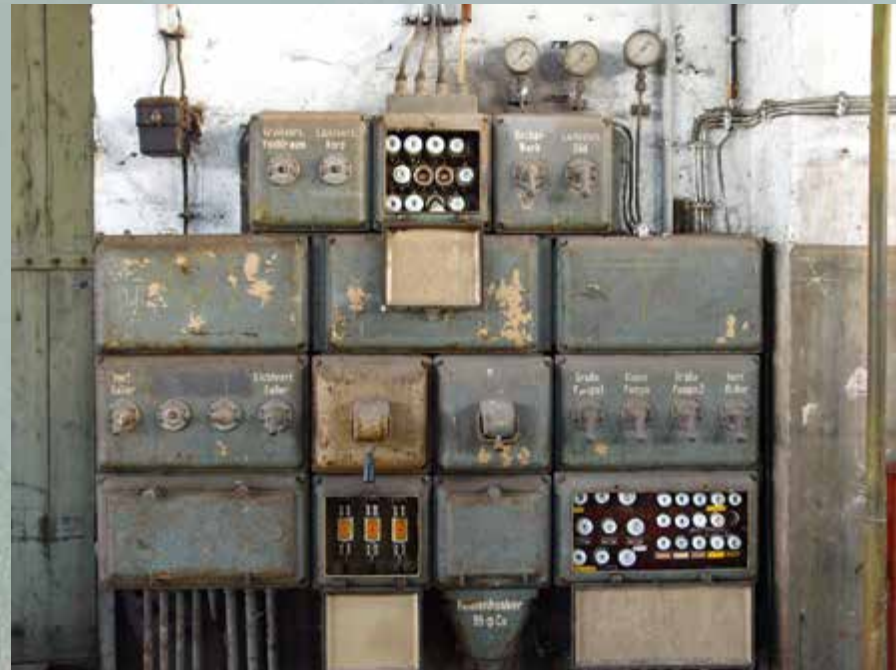
Die elektrischen Anlagen stehen auf Aus.
