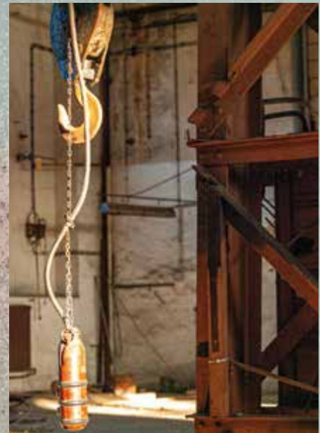
Teilansicht der Krananlage.
